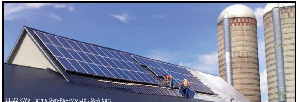
11.22 kWp: Ferme Ben-Rey-Mo Ltd., St-Albert
